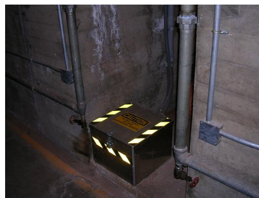
Рис. 3. Сейсмический регистратор в вентиляционном тоннеле плотины (фото автора)
