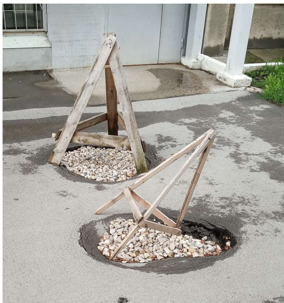
Рис. 2. Провалы по ул. Луначарского в г. Перми (2020 г.)
