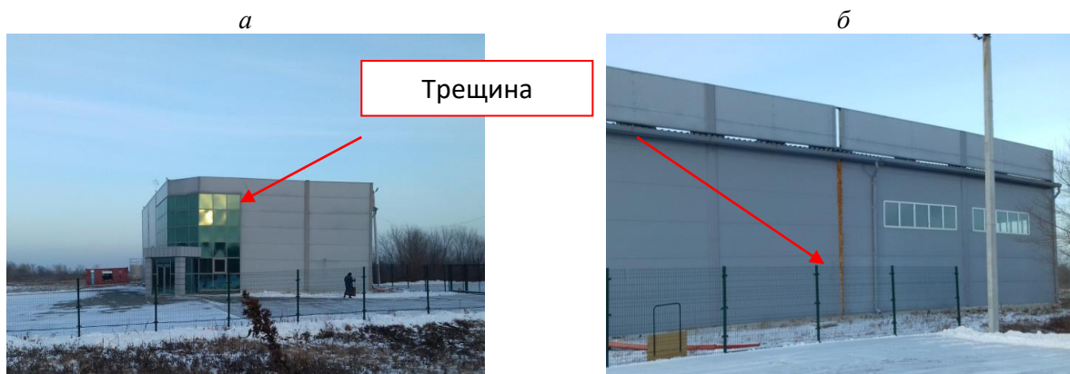
Рис. 1. Холодный склад (в 350 м правее автодороги Абакан-Саяногорск, 15 км+800 м): а – общий вид, б – деформация стен здания
