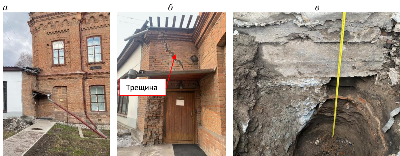
Рис. 3. Выставочный зал музея Мартьянова в г. Минусинск: а – общий вид, б – деформированный участок стены, в – шурф вблизи деформированного участка стены
